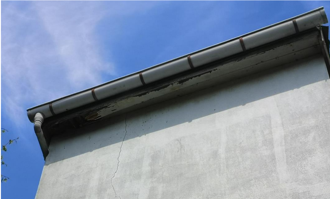
Abbildung 3: Maroder Dachbereich des leerstehenden Gebäudes Ecke Schloßstraße/ Paulstraße mit genutzter Einflugmöglichkeit
