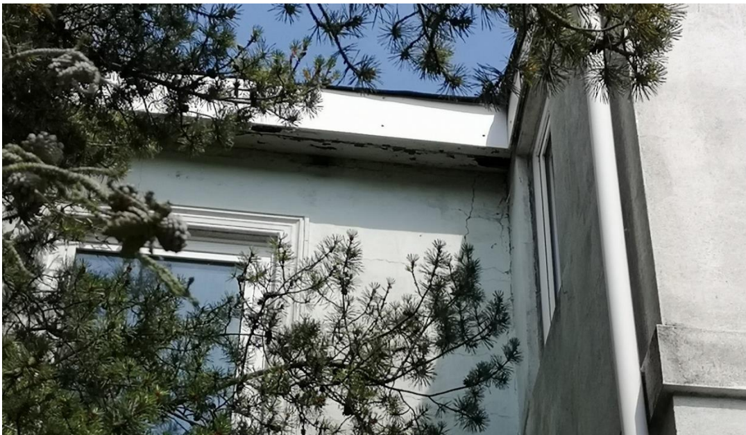
Abbildung 4: Maroder Dachbereich des leerstehenden Gebäudes Ecke Schloßstraße/ Paulstraße mit Spalten als potenzielle Ruhebereiche für Fledermäuse
