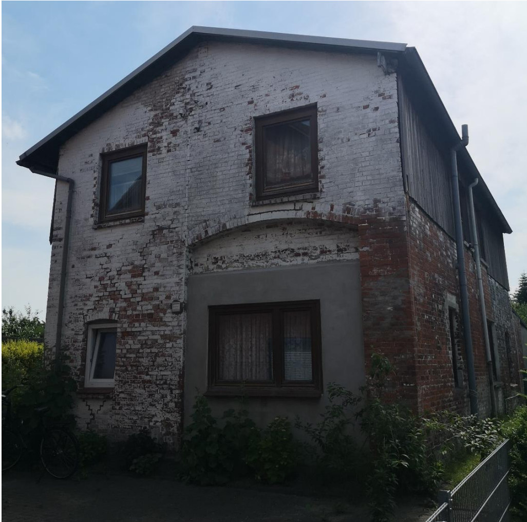
Abbildung 3: Altes Gebäude mit Rissen und anderen Abnutzungen an der Fassade an der Mühlenstraße als potenzielles Fledermaushabitat (Vorderansicht)
